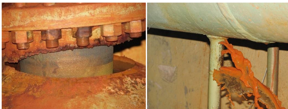
12.3-1 pav. 1-ojo bloko DPCK įrangos pažeidimas atliekant vidaus kontūro dezaktyvaciją
